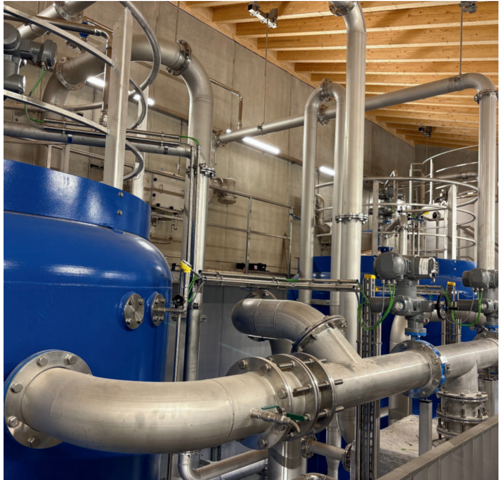
Herzstück des neuen Wasserwerksgebäudes ist die moderne Aufbereitungsanlage, in der das Rohwasser optimal behandelt wird. Zu sehen sind die beiden blauen Filterkessel mit Quarzkies, die Eisen und Mangan aus dem Wasser entfernen. Anschließend gelangt das Wasser in den Reinwassertank (grauer Kessel), von wo aus es in den Hochbehälter weitergeleitet wird. Foto: Zweckverband Wasserversorgungsgruppe Ammersee-West
