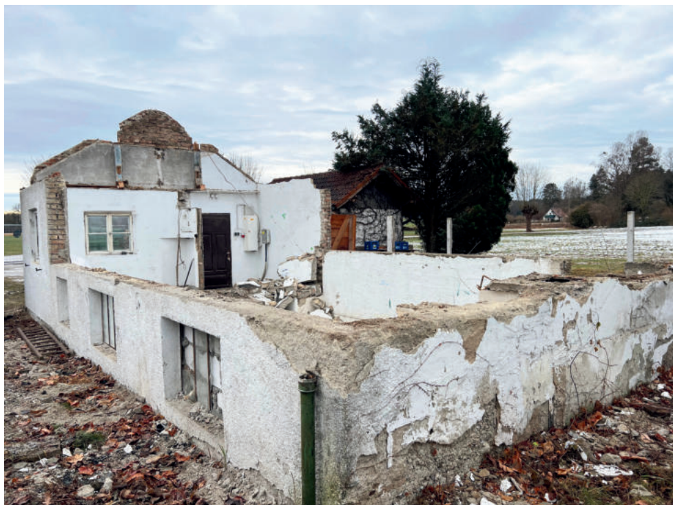
Der Bau des neuen „Holzhäusls“ beginnt: Blick auf das Gelände während der Abbrucharbeiten. Fotos: Unser Dorfe.V.
