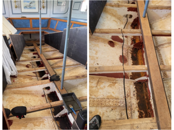
Bild 1, 2 Links: Gesamtansicht der Messe mit demontierten Bodenbrettern zur Freilegung der tragenden Unterkonstruktion. Rechts: Detailaufnahme des Bereichs zwischen zweitem und viertem Spant. Deutlich erkennbar ist fortgeschrittener Korrosionsbefall am Längsträger mit bereits eingetretenem Materialabtrag.
