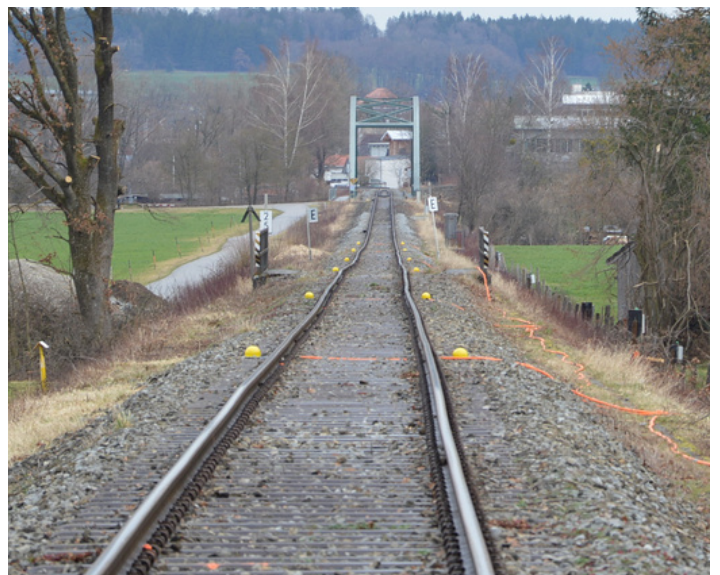
Die Gleisverwerfungen sind ein deutliches Indiz für einen Hangrutsch. Sensoren messen jede Bewegung im Hang
